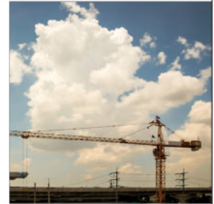
Construction de Centre de Conservation du Louvre - Liévin (62) Maître d'Ouvrage : Musée du Louvre Maître d'Œuvre : Rogers Shirk Harbour + Partner LLP
